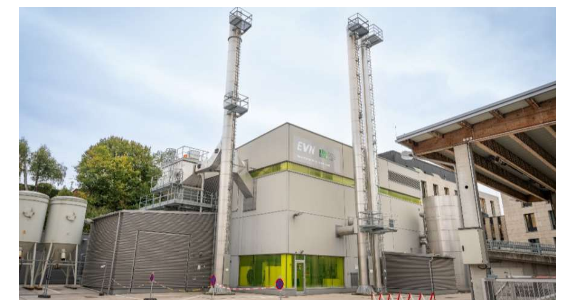
Biomasseheizwerk Maria Gugging
